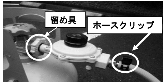
図2 圧力調整器 (ガスボンベ接続)
