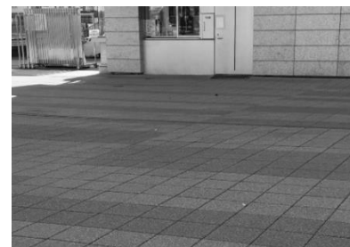
インターロッキングタイル
