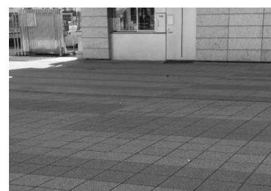
インターロッキングタイル
