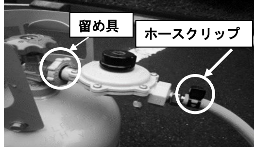
図3 圧力調整器 (ガスボンベ接続)
