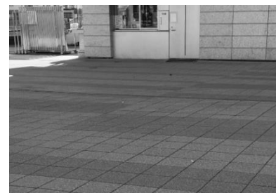
インターロッキングタイル
